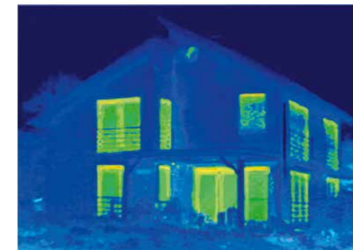
Après l'insertion minutieuse de nouvelles fenêtres issues du système de fenêtres Schüco LivIng, la thermographie révèle l'efficacité énergétique élevée de l'investissement. La perte énergétique initiale est presque entièrement éliminée.
